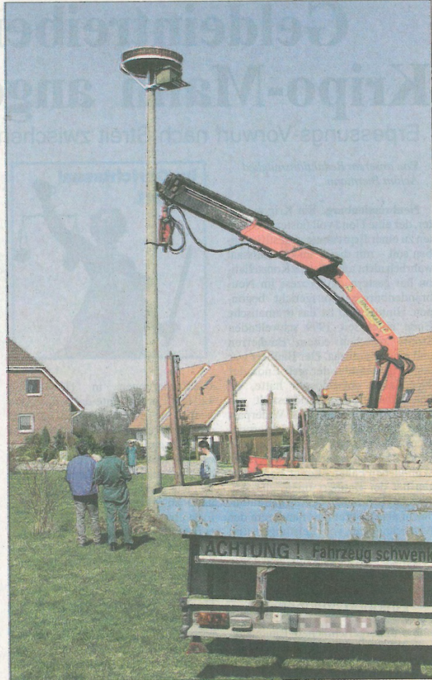
Die Firma Beehrmann half den Woggersinern beim Aufstellen des neuen Storchennestes mitten im Dorf.
