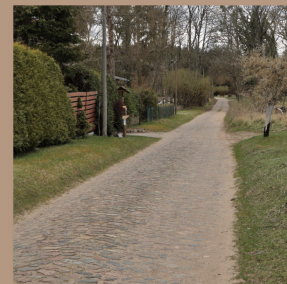
Absenkung der Straße durch Panzer auch heute noch zu erkennen
